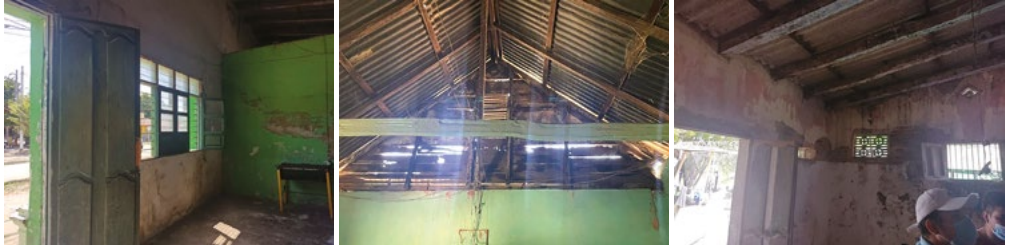
Figura 1. Deterioro al interior de una vivienda vernácula. Fuente: propia.
