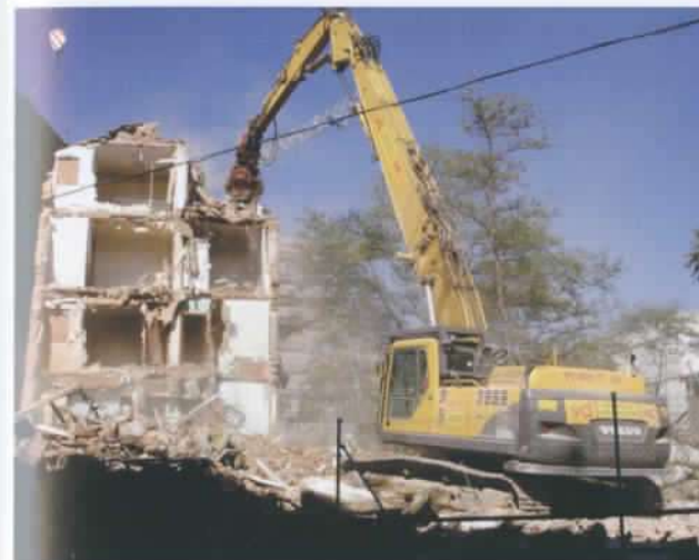
// Generación de escombros
